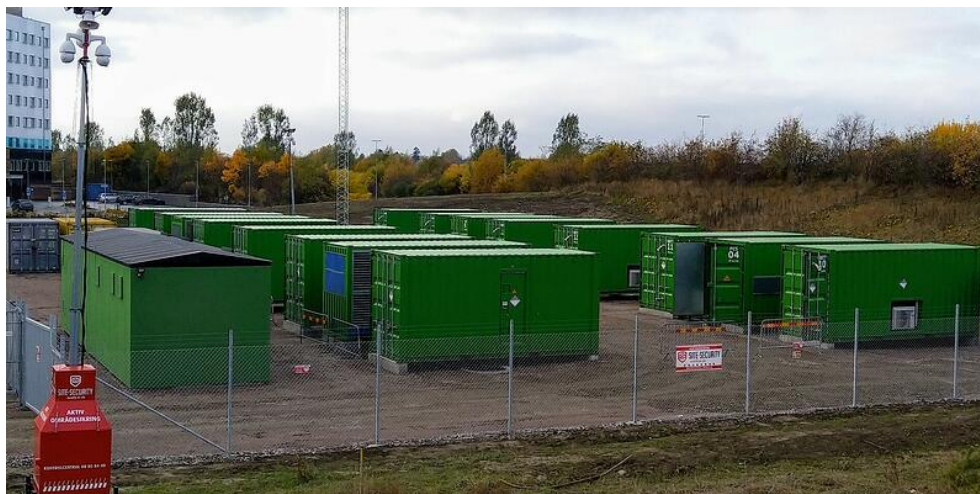
Figur 13. Sveriges största energilager, 20 MWh/5 MW, finns i Uppsala och ägs av Vattenfall. Batterilagret används när elnätets kapacitet inte räcker till vid hög efterfrågan på el. (Bild: Vattenfall)
